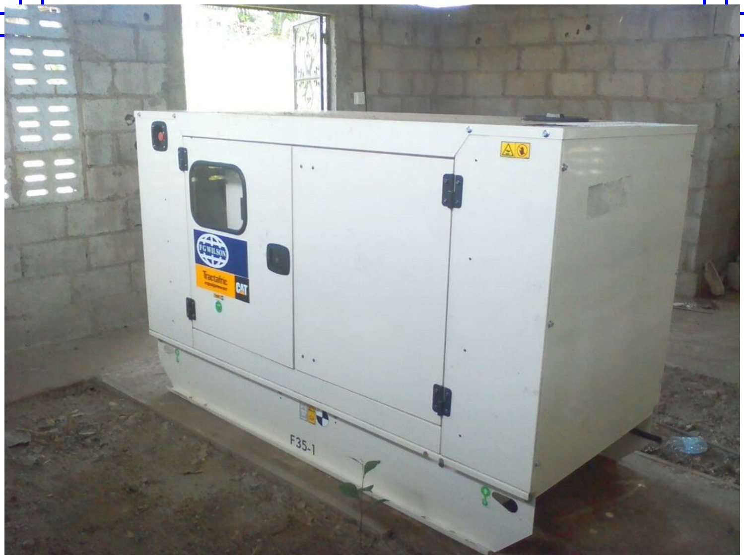
FG WILSON F35 de 35 KVA insonorisé et 01 inverseur automatique INS60
